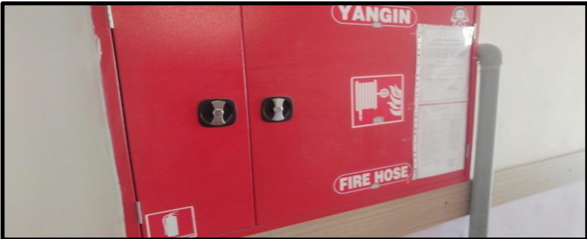
Yangın dolabı işaretlenmiş ve destek elemanlarının ismi asılmış.
