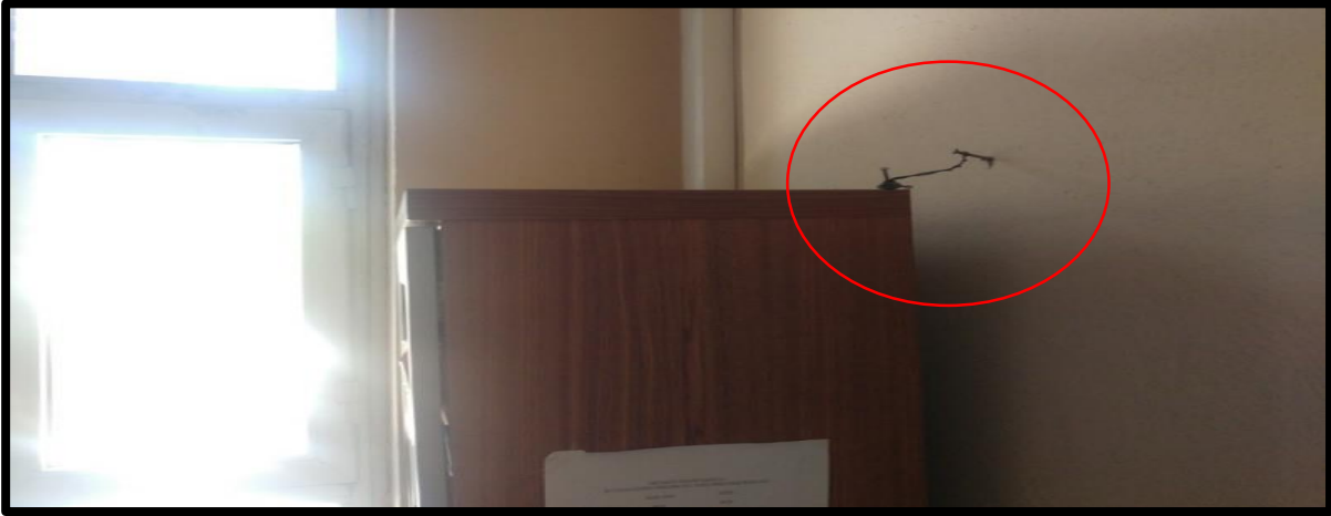
Dolapların sabitlenmesi yanlış,Bu durumdaki sabitlemelerde dolap ivme kazandıkça daha tehlikeli hal alabilir.
